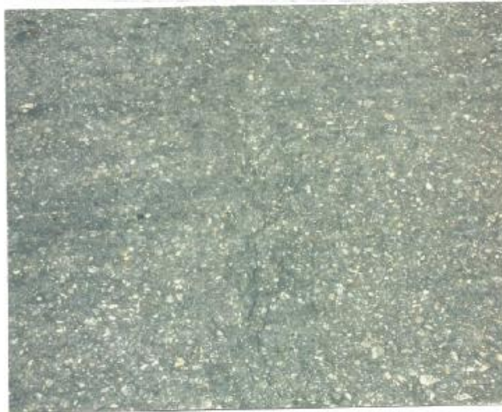
صورة (٤) تشتت الطرق المبعدة على الجانب الايمن للمنتجة نحو السليمانية بعد مدخل النفق بحدود ٧٠٠ ( ٢٠ / ٥ / ٢٠١٢ )
